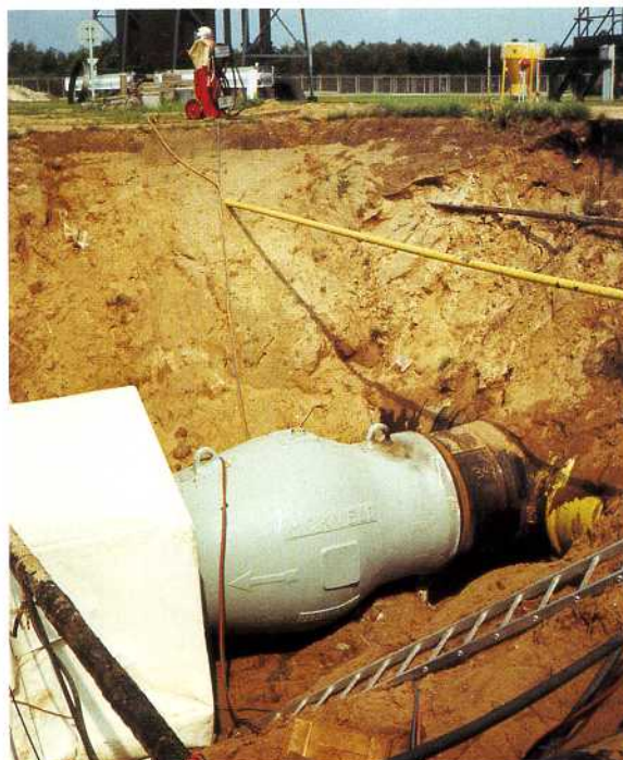
Бесшумный обратный клапан 42" ANSI 600 фунтов ввареный в засыпанный газопровод, байпас компрессорной станции, Нидерланды.
