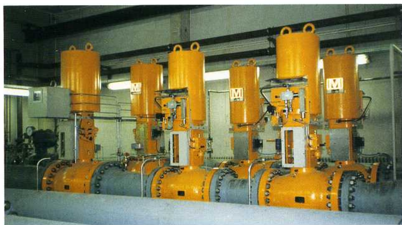
Регулирующие клапаны давления 20" ANSI 600 фунтов, предохранительные отсечные клапаны 16" ANSI 600 фунтов, измерительно-регулирующая станция, Германия.
