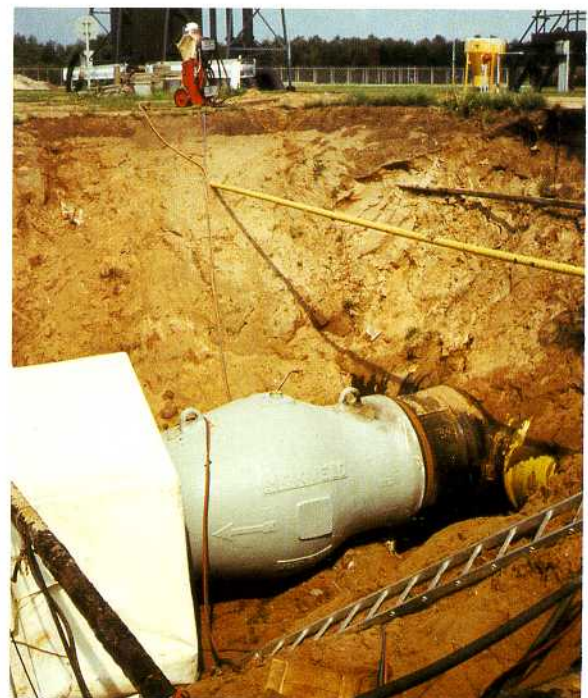
Бесшумный обратный клапан 42" ANSI 600 фунтов ввареный в засыпанный газопровод, байпас компрессорной станции, Нидерланды.
