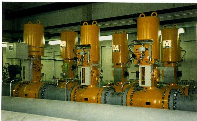
Клапаны регулирования давления 20" ANSI 600 и предохранительные отсечные клапаны 16" ANSI 600 на газоизмерительно-редукционной станции, Германия
