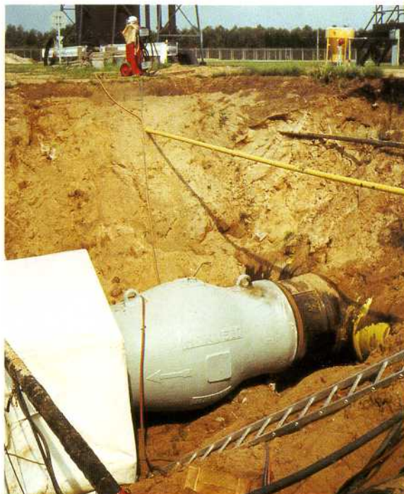
Бесшумный обратный клапан 42" ANSI 600 фунтов свареный в засыпанный газопровод, байпас компрессорной станции, Нидерланды.
