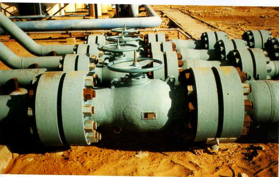
Отсечные клапаны 12" ANSI 2500 фунтов, водоинжекторный трубопровод на нефтяном промысле в Алжире.
